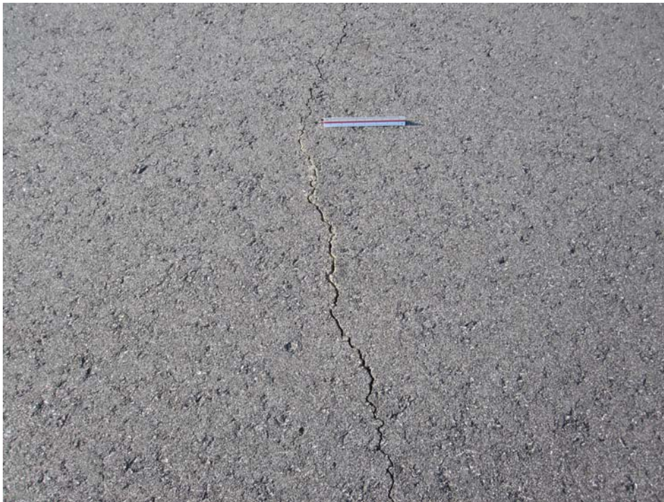
TIAB-10. Longitudinal and Transverse Cracking (Sample Unit #67).
