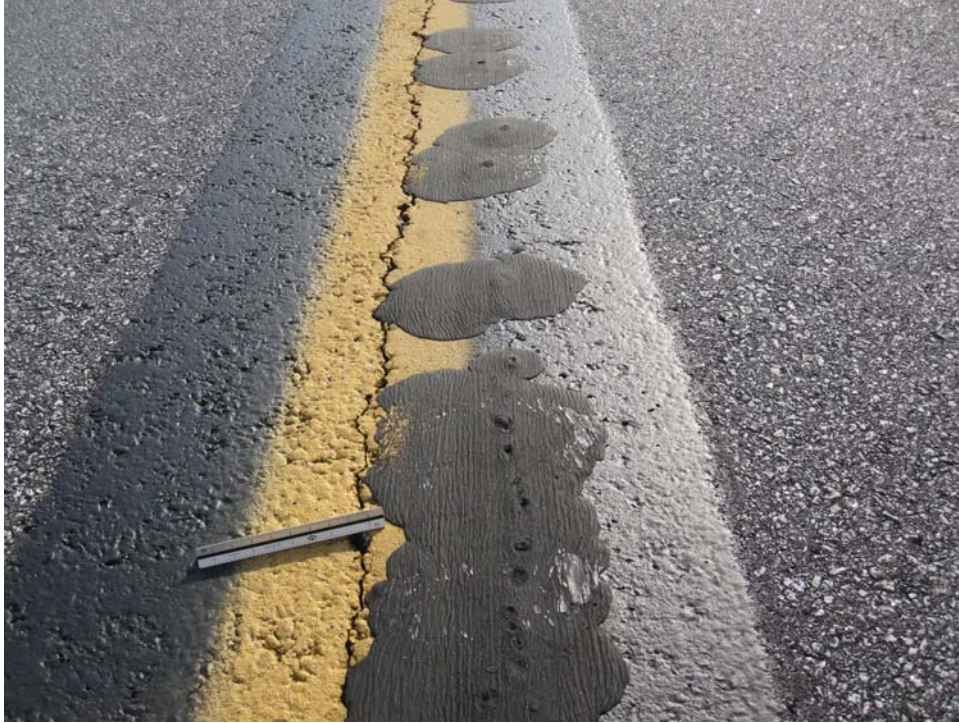
TIAB-10. Bleeding (Sample Unit #20).
